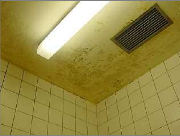
Der Schimmel gedeiht gut an den Decken und Wänden der Duschen in der „Arena“.
