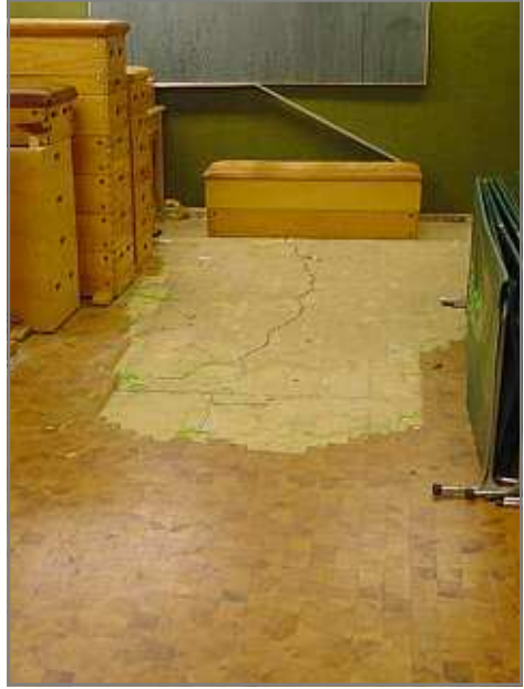
Durchgang zur Halle und den Umkleideräumen. Nach einem Wasserschaden vor 2 Jahren Baustelle ohne Arbeiter und Unfallgefahr für
