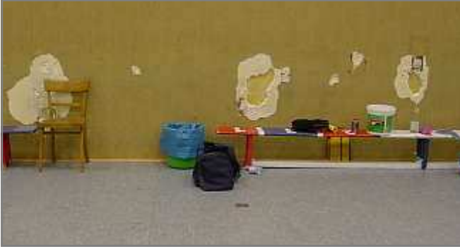
Schlecht - ob Bohrlöcher....
